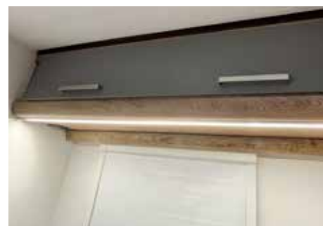
Interiérové LED osvětlení.
